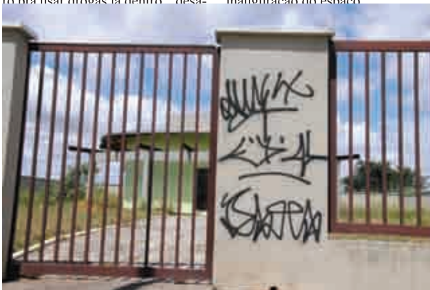
A fachada está toda pichada
